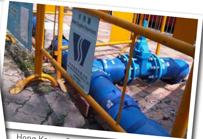
Hong Kong - Su Dağıtım Hattı Hong Kong - Water Distribution Lines
