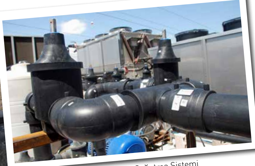
Türkiye - Soğutma Sistemi Turkey - Cooling System
