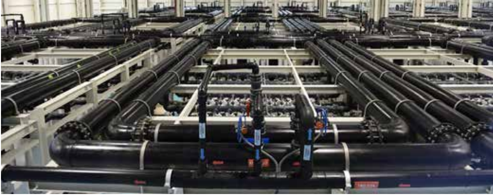
Azerbaycan - Bakü Temiz Su Hattı Su Arıtma Tesisinde 3700 adet EF Semer ve 19,500 Manşon Kullanımı Azerbaijan - Bakü Infiltration - Water Treatment Plant 3,700 EF Saddles and 19,500 Fittings Connection
